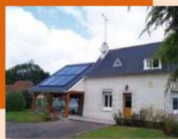
> Capteurs thermiques intégrés en toiture secondaire (Chauffage)
