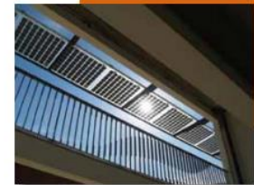
> Capteurs photovoltaïques en brise-soleil
