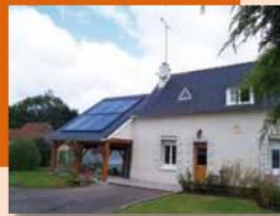
> Capteurs thermiques intégrés en toiture secondaire (Chauffage)
