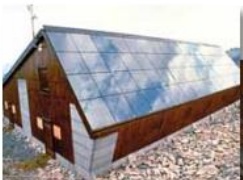
> Toiture complète en photovoltaïque
