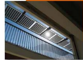
> Capteurs photovoltaïques en brise-soleil
