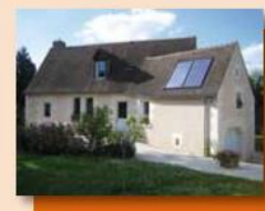
> Capteurs intégrés en toiture (CESI)
